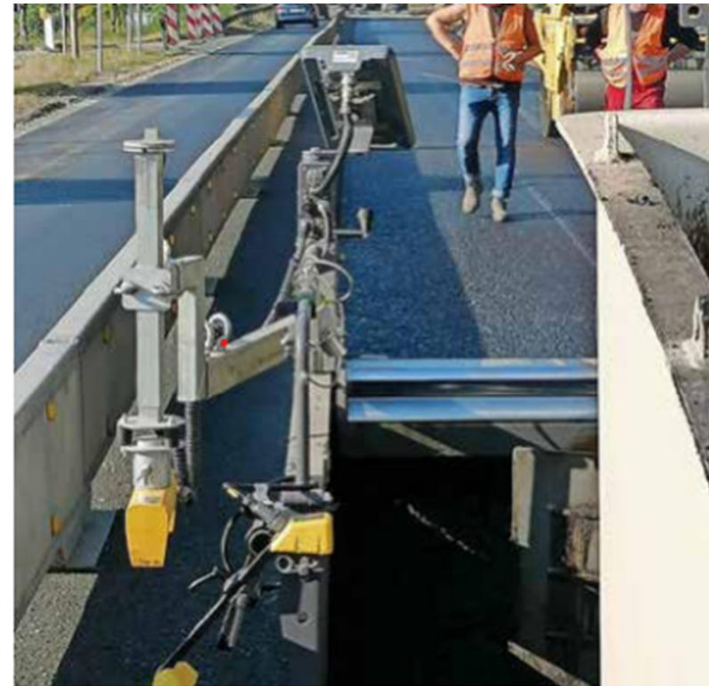
Bild 4: Sicherheitsgewinn durch den Einsatz von Sensoren
