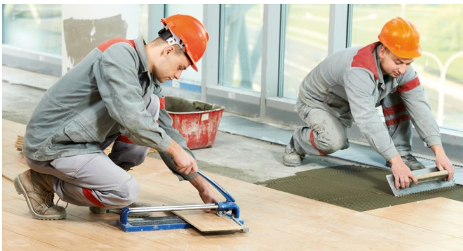
Kniende und vorgeneigte Körperhaltungen sowie körperfernes Arbeiten beim Bodenlegen.
